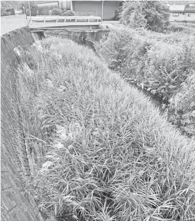
池谷川の繁茂した状況
