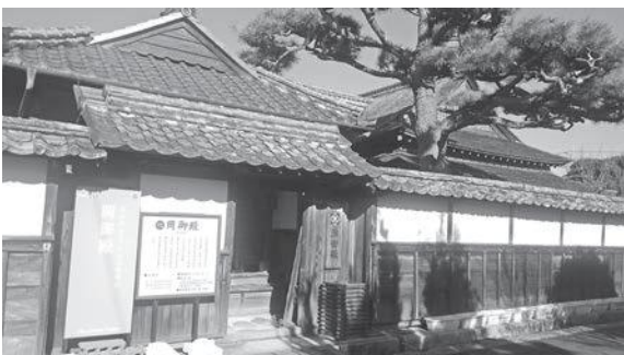
大規模修繕が必要な岡御殿
