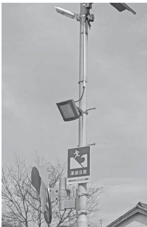
防犯灯に設置された避難誘導灯
