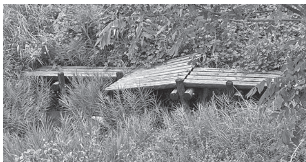
二十三士公園の破損した木製の歩道橋
